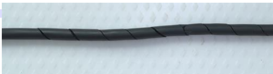
Abb. 1: Umlaufende Spiralarisse an einem O-Ring: Gut erkennbar ist der typische 45°-Winkel. Ein geringes Verhältnis Schnurstärke zu Innendurchmesser begünstigt die Bildung von Spiralarissen.
